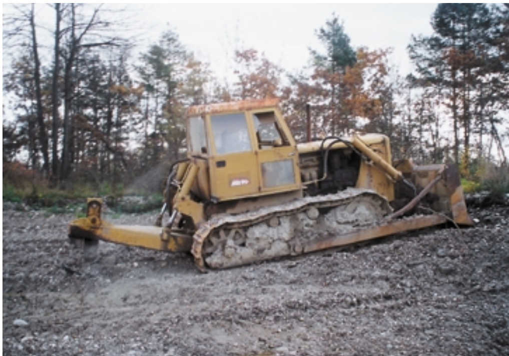
Slika 2-4: Ali si bomo kljub opozorilom zastrupili vodo?
