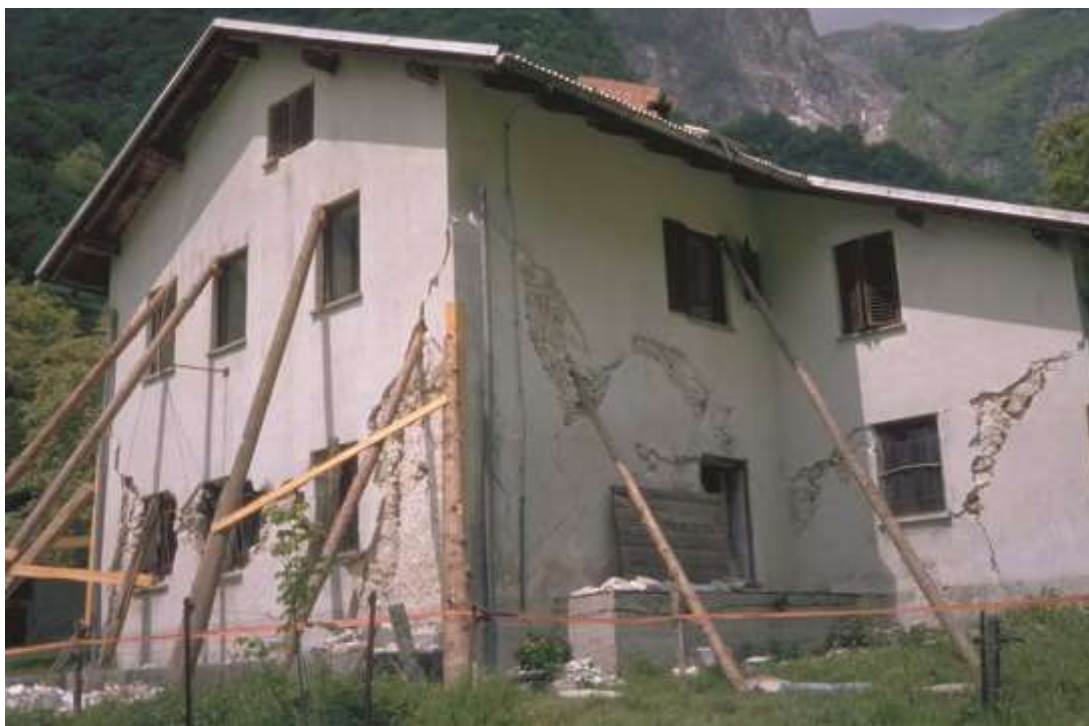
Slika 30: Globoke razpoke v vseh nosilnih stenah in delna porušitev vogalov konstrukcije so značilne poškodbe objektov iz neobdelanega kamna.
