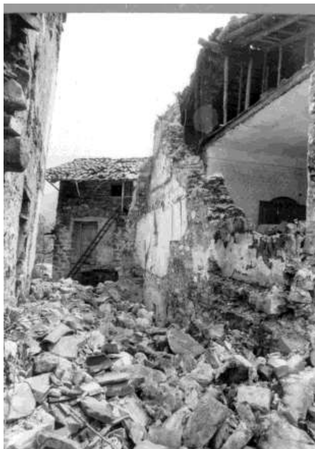
Slika 25: Porušeni objekti v Breginju.
