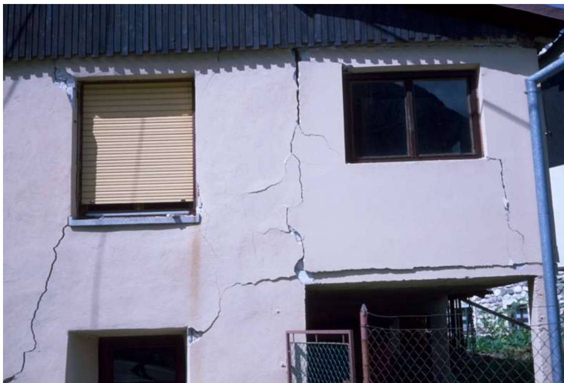
Slika 35: Močno poškodovana zgradba v Čezsoči kaže neprimerno dozidavo prizidka.
