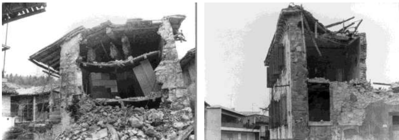
Slika 23: Poškodovan objekt v Breginju. (levo)
